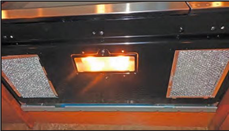
Figure 0-4: Air Filtration Fan
