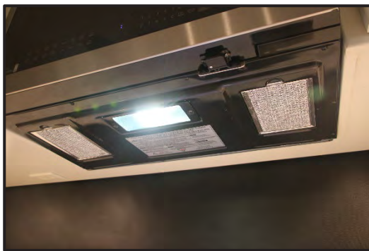
Figure 5-4: Air Filtration Fan
