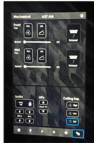
Figure 16-5: Vent Fan Switch
