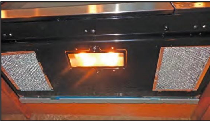
Figure 6-4: Air Filtration Fan
