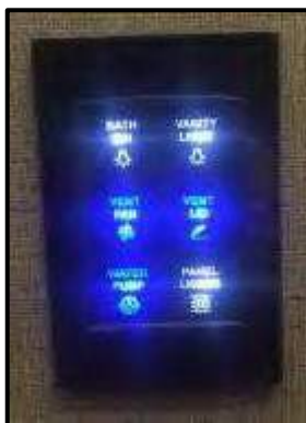
Figure 15-6: Vent Fan Switch
