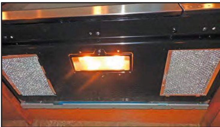
Figure 6-4: Air Filtration Fan
