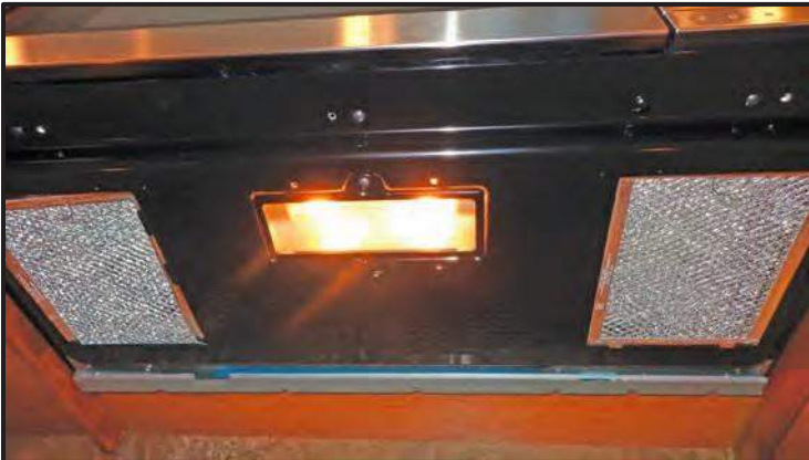
Figure 5-4: Air Filtration Fan
