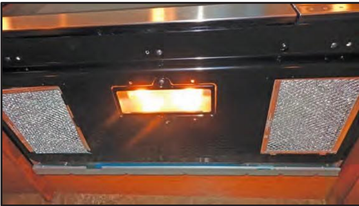
Figure 0-4: Air Filtration Fan
