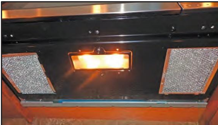
Figure 5-4: Air Filtration Fan
