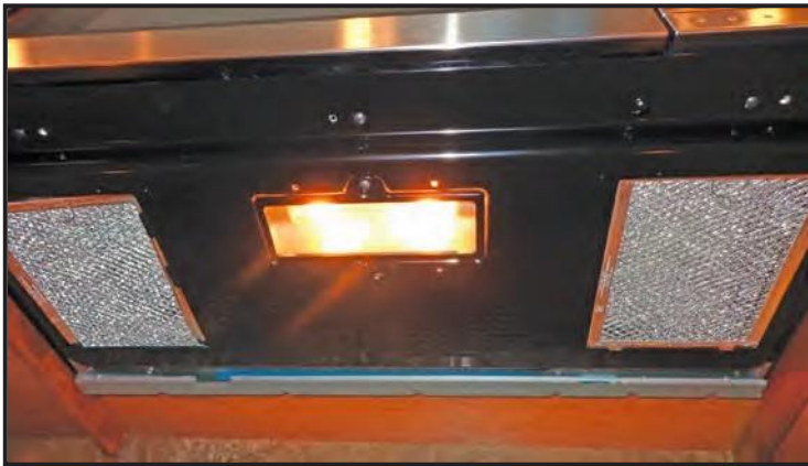
Figure 5-6: Air Filtration Fan
