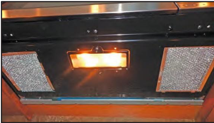
Figure 5-6: Air Filtration Fan
