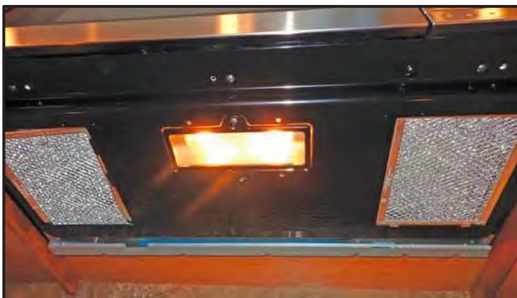
Figure 5-4: Air Filtration Fan
