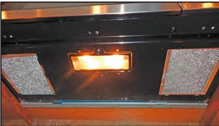
Figure 6-4: Air Filtration Fan
