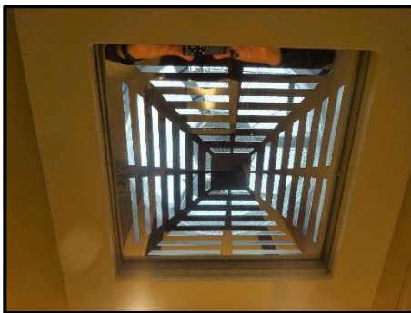
Figure 15-4: Overhead Vent Fan
