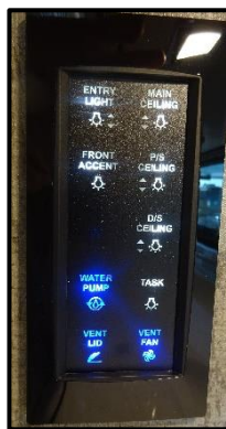
Figure 15-6: Vent Fan Switch
