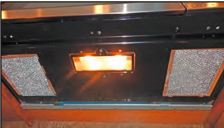
Figure 5-4: Air Filtration Fan
