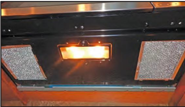
Figure 5-4: Air Filtration Fan
