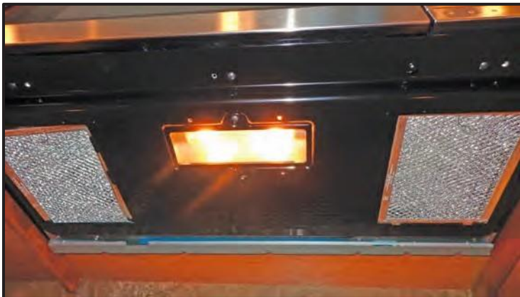
Figure 5-4: Air Filtration Fan
