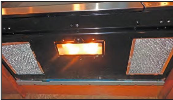
Figure 5-6: Air Filtration Fan
